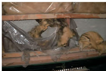
結露により劣化した断熱材
