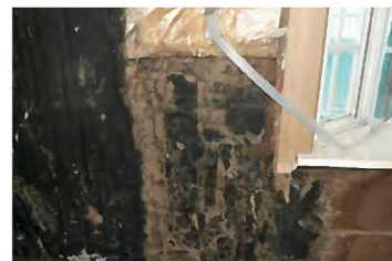
結露によりカビが生えた断熱材
