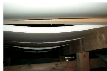
変形したボード系断熱材
